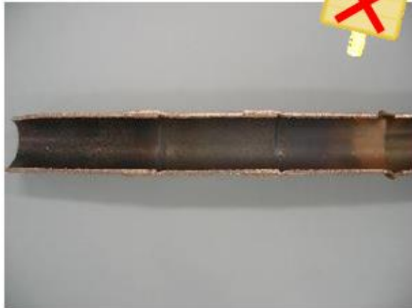
Không thổi nitơ Mặt trong ống bị đen do lớp ôxít
