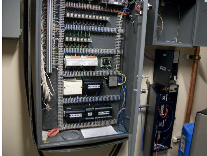
Hình ảnh đấu nối tủ điện DDC
